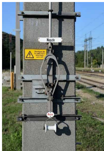
Abbildung 13a: Ladegleisschalter in Stellung „AUS“
