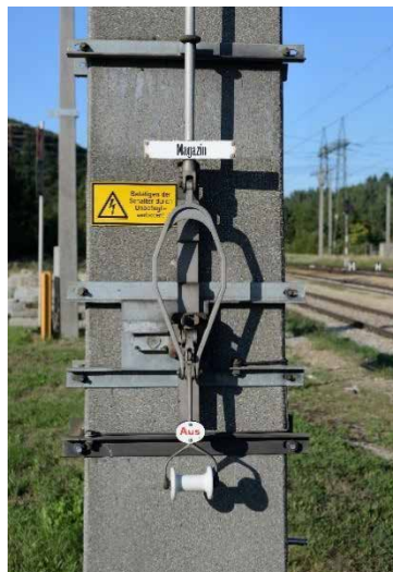
Abbildung 13a: Ladegleisschalter in Stellung „AUS“
